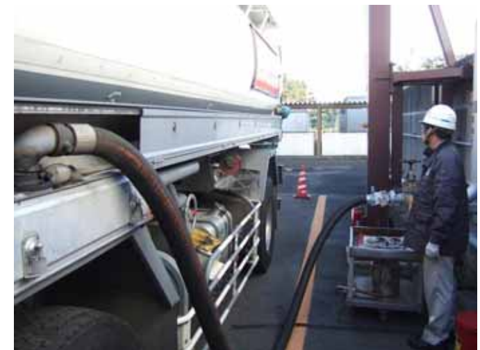
タンクローリーによる発電所への燃料受入状況 (平成23年当時の写真ではない)
