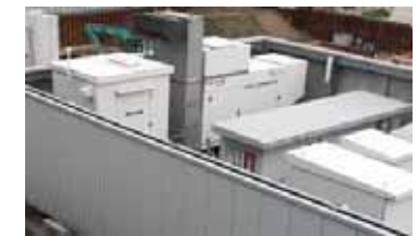
非常用ガスタービン発電機 (屋上設置)
