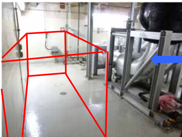
代替循環冷却系ポンプ(B) 設置場所イメージ
