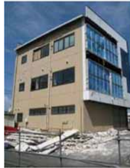
瓦礫は建屋周辺に堆積
