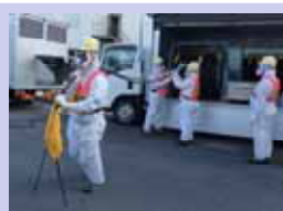
可搬型代替低圧電源車の設置・運用
