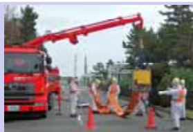
可搬型代替注水ポンプ車の設置・運用
