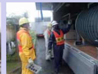
降雨時の電源車の設置・運用
