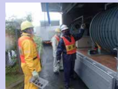
降雨時の電源車の設置・運用
