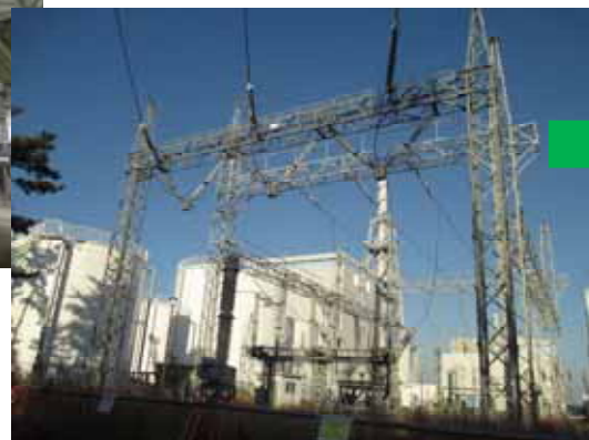
気中開閉所(取替前)
