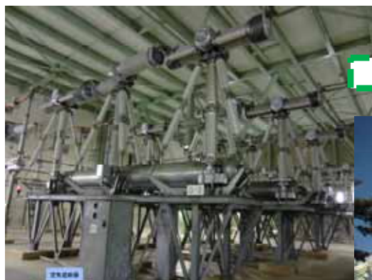
気中開閉所(取替前)
