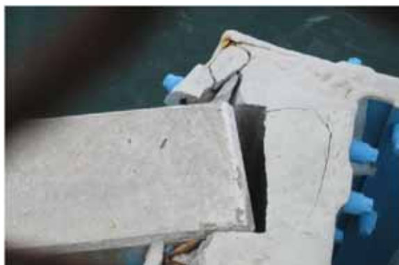
写真③: 躯体の変形
