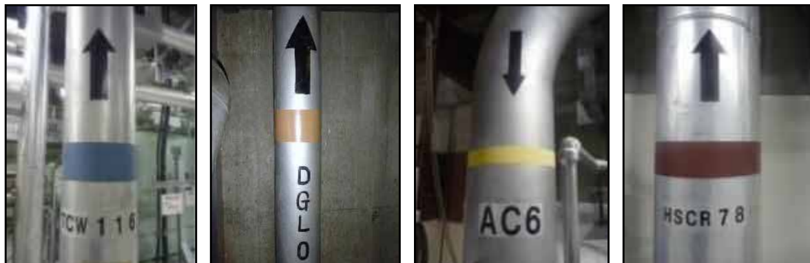
水配管: 青 TCW: タービン補機冷却水系 油配管: 暗い黄赤 DGLO: 非常用ディーゼル発電機潤滑油系 ガス配管: 黄 AC: 不活性ガス系 蒸気配管: 暗い赤 HSCR: 所内蒸気復水戻り系
