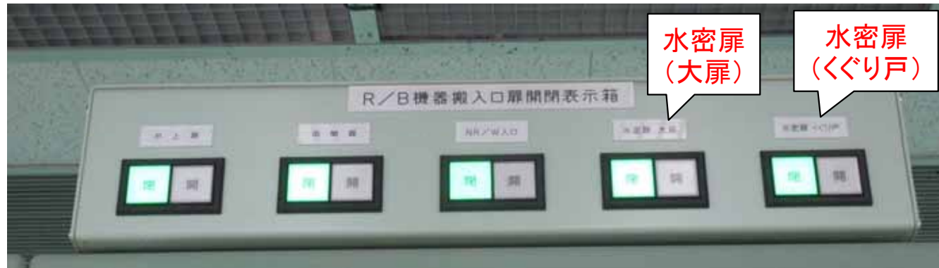
図1 原子炉建屋機器搬入口水密扉の開閉表示灯(中央制御室)
