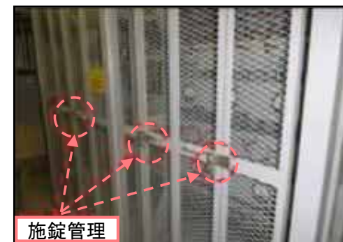
③計装ラック防護フェンスの施錠管理
