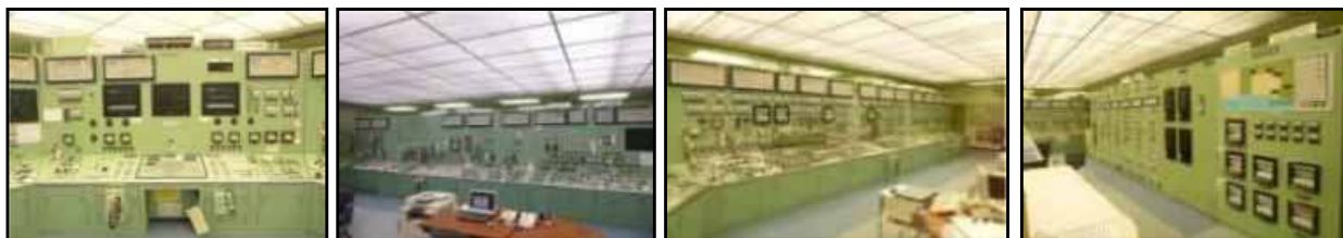
①原子炉制御盤 ②原子炉補機及び非常用炉心冷却系制御盤 ③タービン・発電機及び所内電源系制御盤 ④外部電源系統及び環境監視盤
