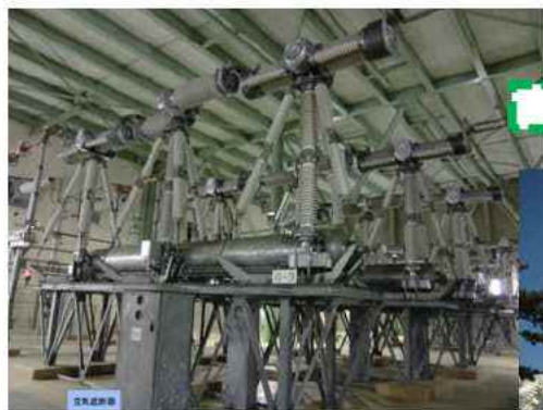
気中開閉所(取替前)
