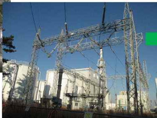
気中開閉所(取替前)
