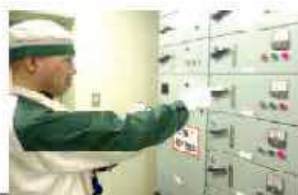
① 日常点検(機器の電流値確認)
