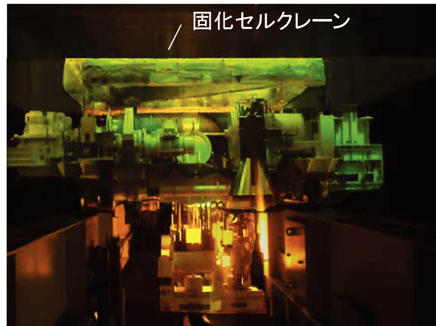
固化セルクレーン
