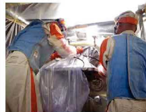
⑤ 点検保守(フィルタ交換)
