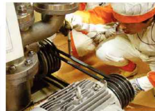
④ 点検保守(排風機のベルト交換)
