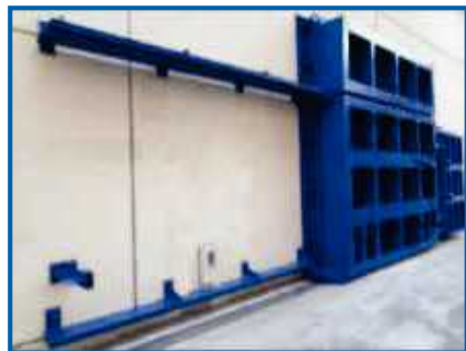
浸水防止扉(設置済み)
