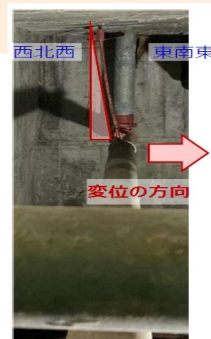
脱落箇所B
