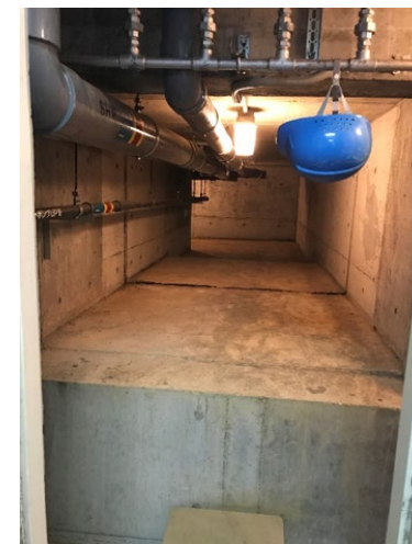
第四実験棟 管理区域外配管
