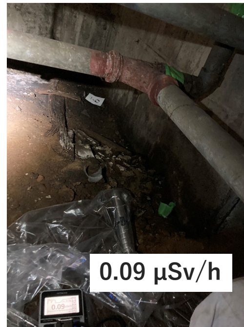
脱落箇所B
