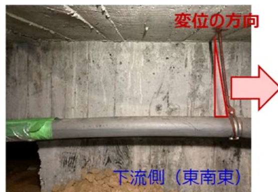
破断配管 A下流側吊り金具
