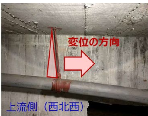
破断配管A 上流側吊り金具
