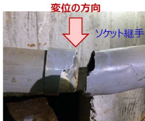
破断配管A 破断部
