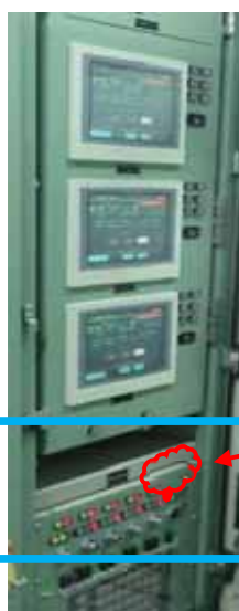
当該制御盤外観（外扉内）
