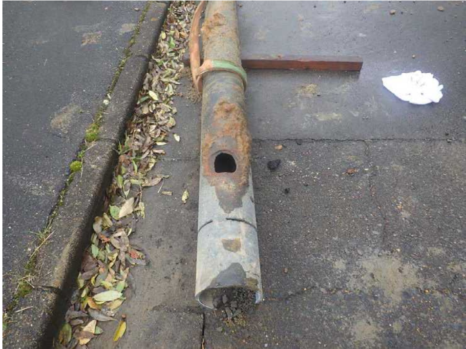
写真5 破損した埋設配管
