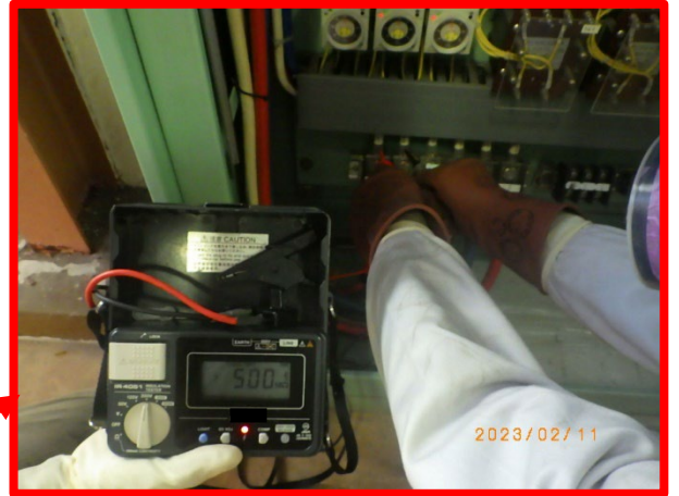
動力盤(排気ブロア電動機の系統)の絶縁抵抗の測定結果： > 5 0 0 M \Omega
