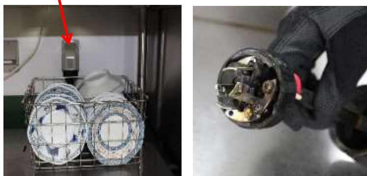
図 1-2 当該コンセントと分解点検後のプラグ
