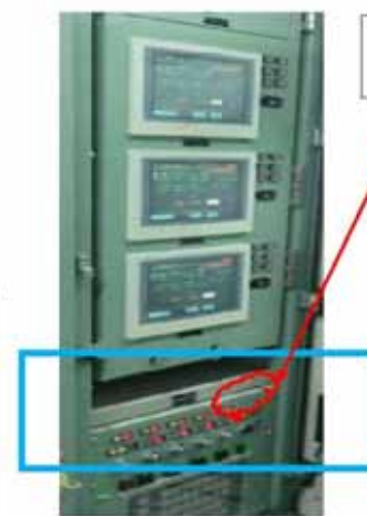
当該制御盤外觀（外扉内）
