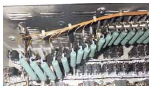
当該制御盤内
