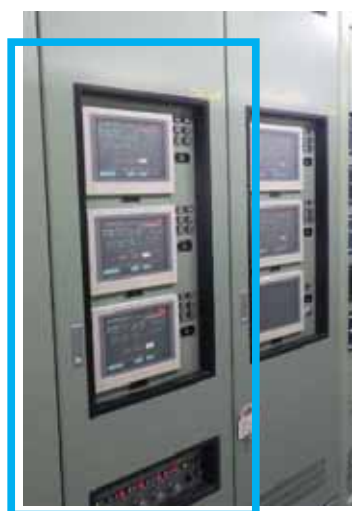
当該制御盤外観
