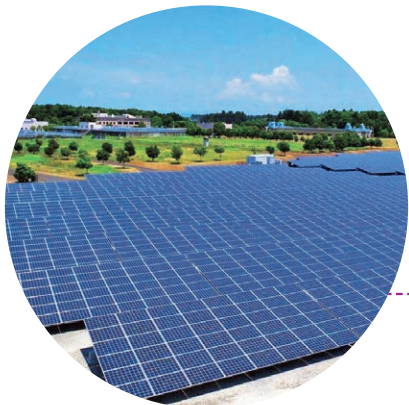
茨城県企業局 太陽光発電設備 水戸浄水場
