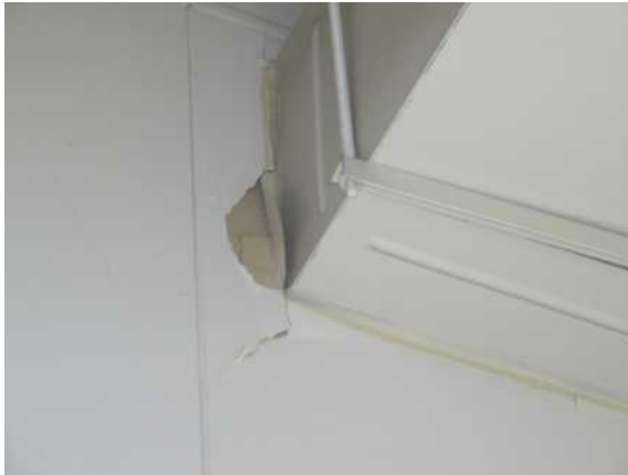
入口ダクト付近の隙間
