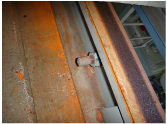
30 トンクレーン, レール固定ボルト緩み
