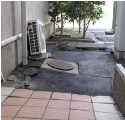
原子力専攻 研究棟・研究棟別棟間 道路アスファルト段差，亀裂
