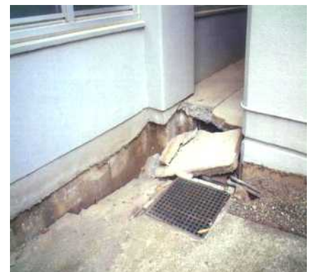
原子力専攻 原子炉建屋外 で発生した段差
