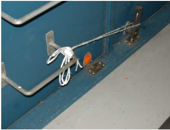
ローディングドック大扉の ロックピンの破損
