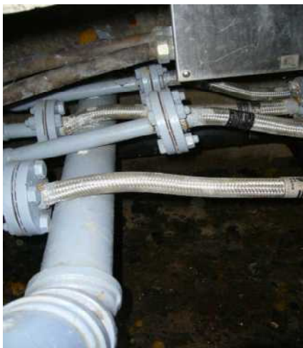
重油配管の変形
