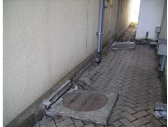
東海保障措置センター敷地内での陥没箇所
