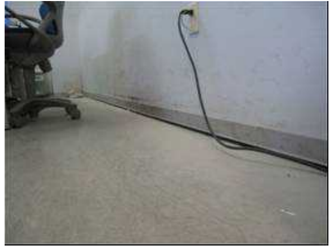
ガンマ線照射施設（管理区域外） 出荷室詰所の壁一床に隙間
