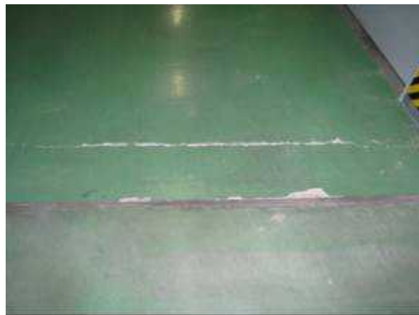
電子線照射施設（管理区域外） 連絡通路床の亀裂・段差
