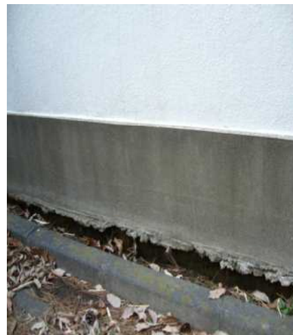
地盤沈下による外壁の浮き上がり
