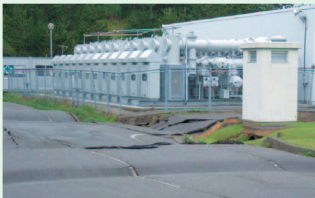
液化化現象により陥没した発電所構内道路 東京電力(株)提供7月17日撮影
