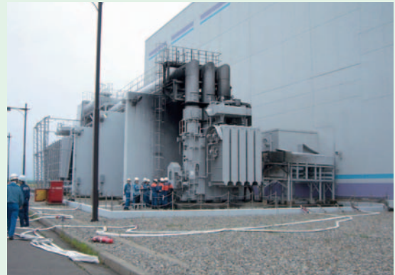
出火した3号機所内変圧器の状況 新潟県提供7月17日撮影
