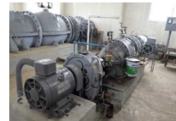
用排水ポンプ設備
