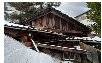
地震による木造住宅の被害
