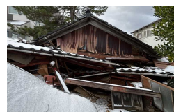
地震による木造住宅の被害
