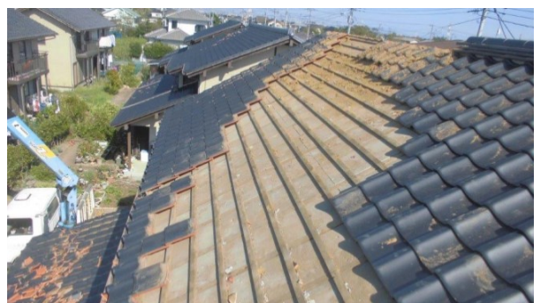
被災した住宅(屋根瓦の剥落)
