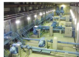
そうすい 送水ポンプ
