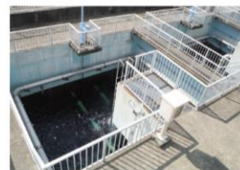
きゅうそくろかち 急速ろ過池
